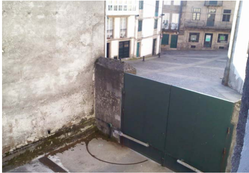
Fig. nº 4: Puertas de acceso que comunican el jardín de Amarante con la Plaza de Salvador Parga
